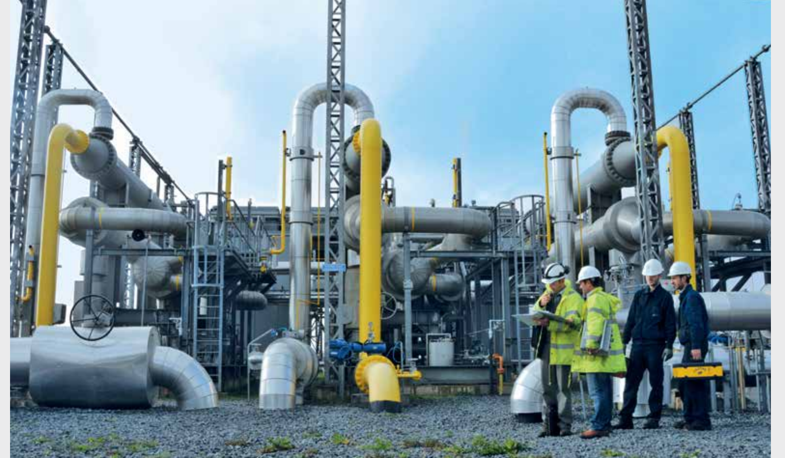
TPAO / Silivri Doğalgaz Depolama, 2009
