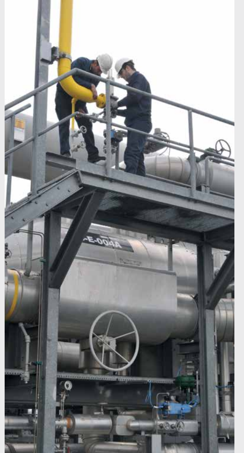
TPAO Marmara Ereğlisi, Doğalgaz Depolama Servisi, 2010
