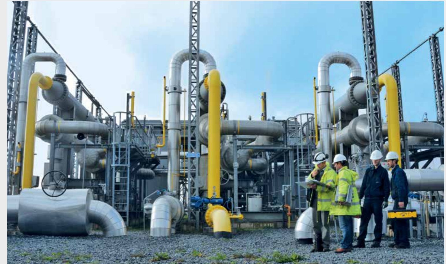
TPAO / Silivri Doğalgaz Depolama, 2009
