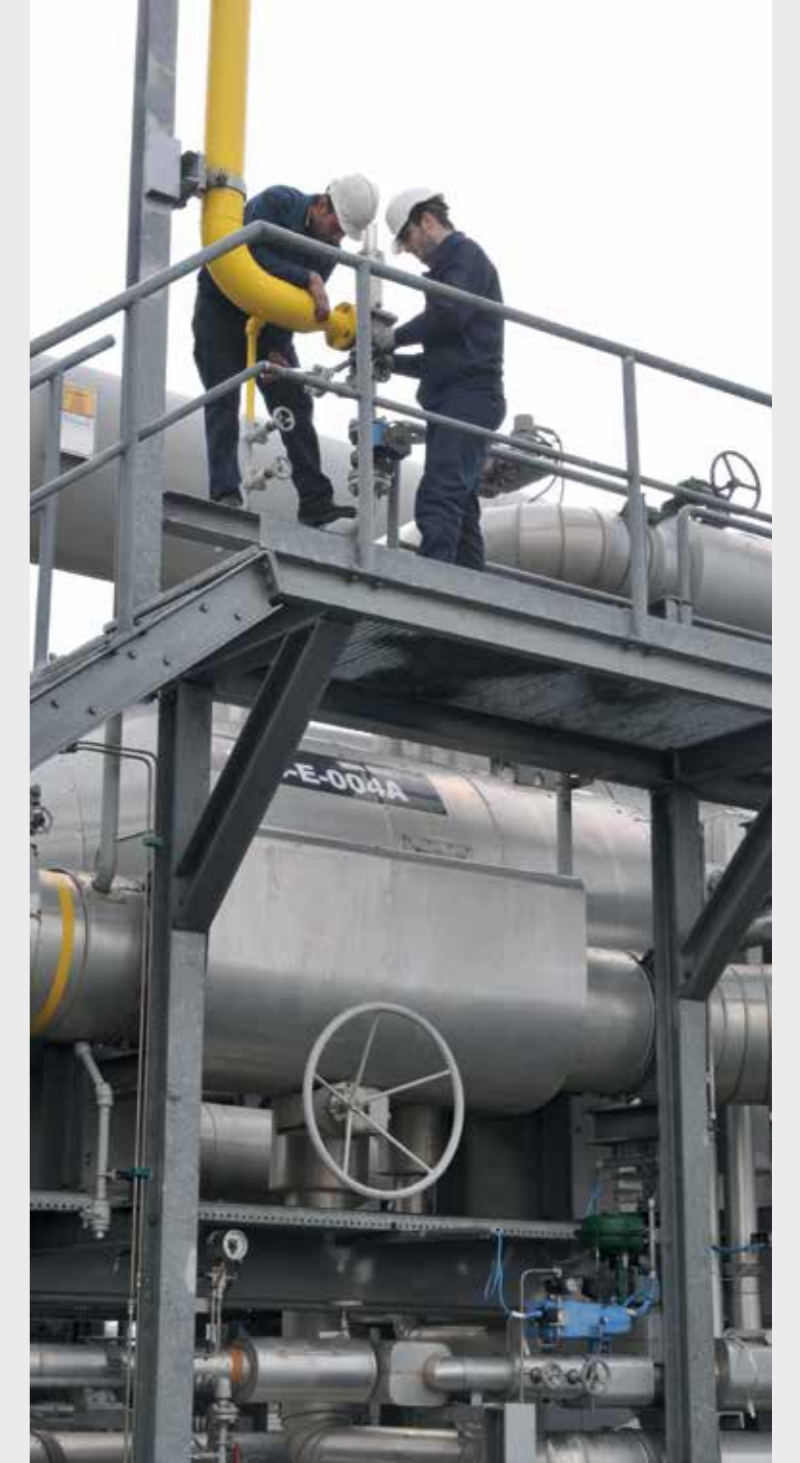
TPAO Marmara Ereğlisi, Doğalgaz Depolama Servisi, 2010
